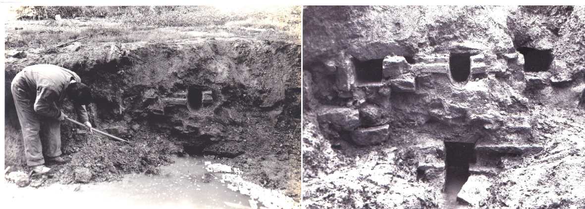
L'arrivée des canalisations au regard Pavic
